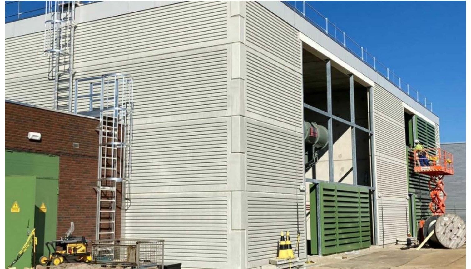
Trafocellen gevel beton, Mombarg - Station Tiel
