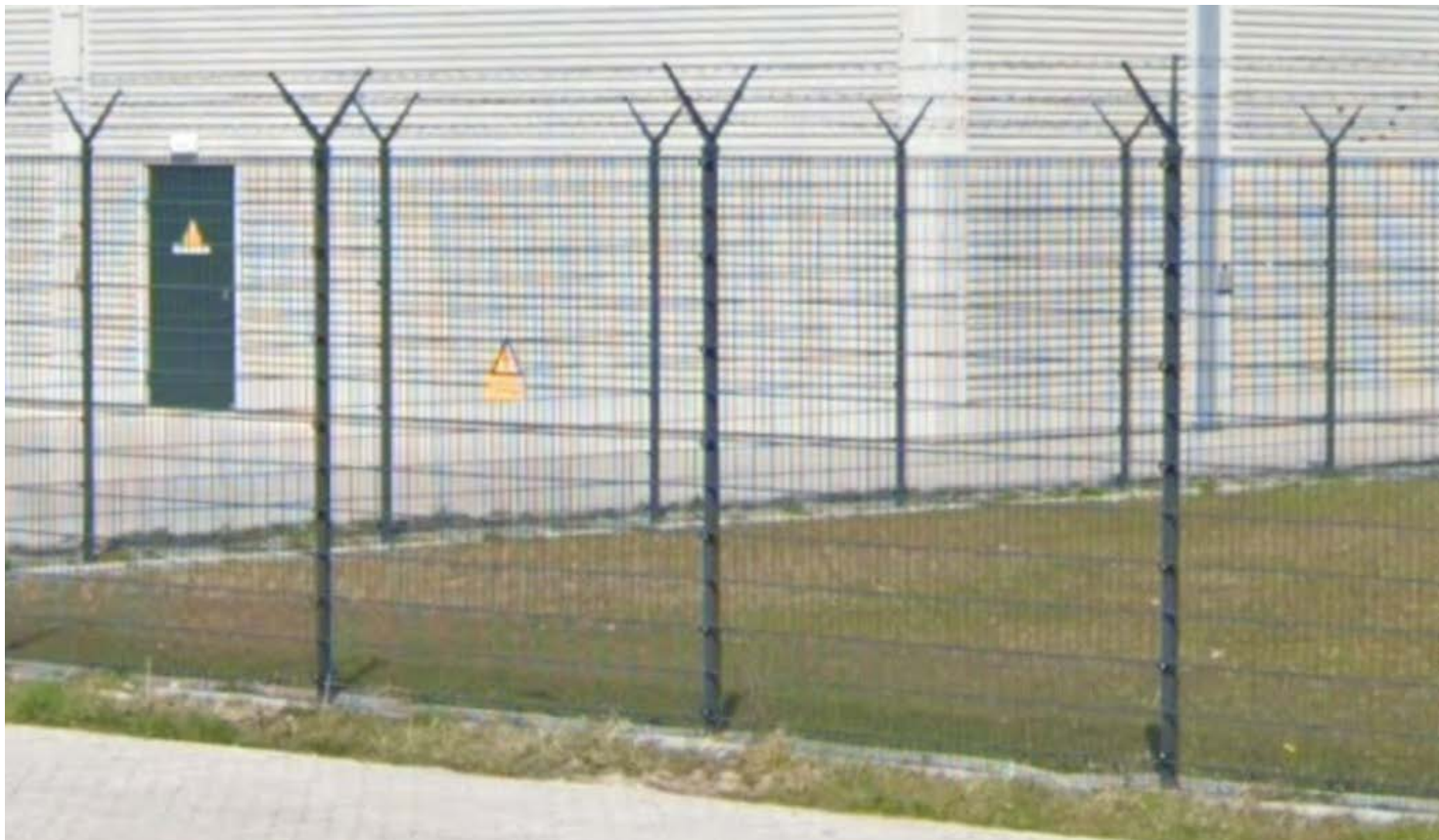
Standaard hekwerk rondom Liander terrein
