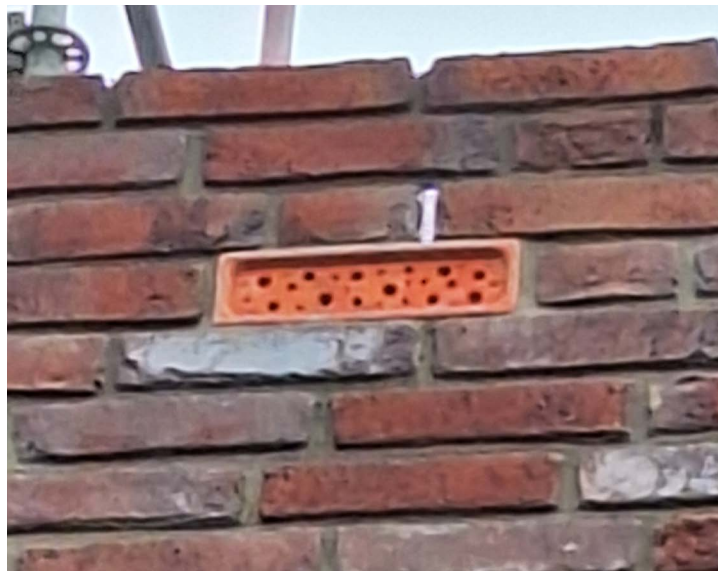
Bijensteen in gevel (Liander, 50kV GIS hal op OS Ede)
